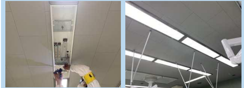
蛍光灯からLED照明で「節電」「CO2削減」
